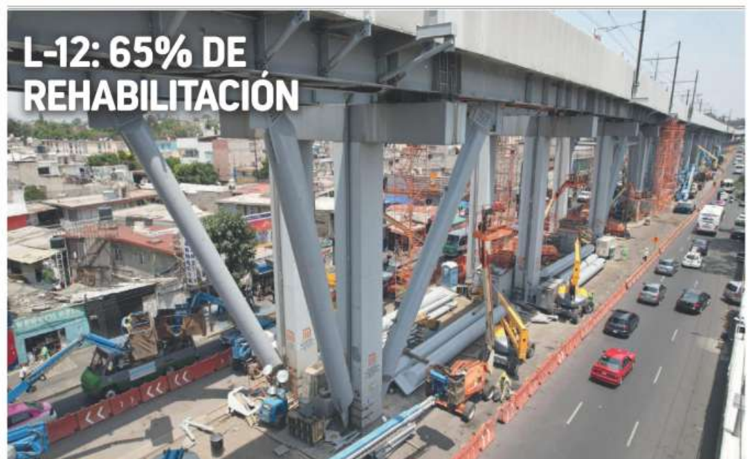
A 2 AÑOS DE LA TRAGEDIA. El Gobierno de la Ciudad de México informó que, a casi dos años de iniciada la rehabilitación de la Línea 12 del Metro luego de que se diera el colapso de un tramo de la parte elevada el 3 de mayo de 2021 que dejó 26 personas muertas y una centena de lesionados, el avance es de 65 por ciento y prevé que en el último trimestre del año se concluya. Por Eña Cruz Calleja. Foto: Cuartoscuro. Pág. 10
